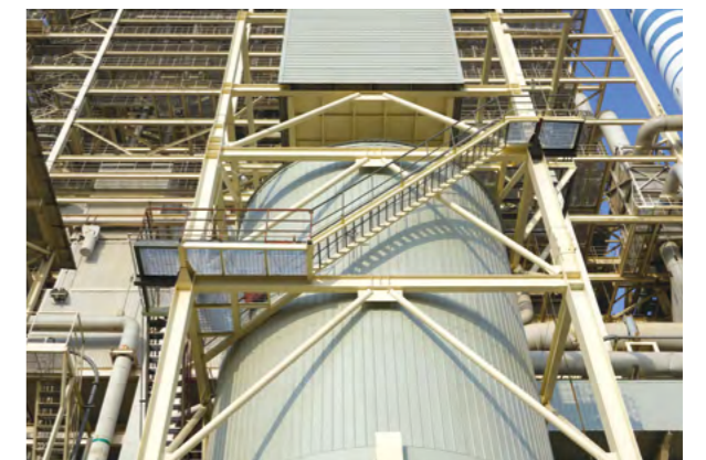
安徽当涂发电公司废水零排改造工程 2 号干燥塔系统顺利通过 168 小时试运
